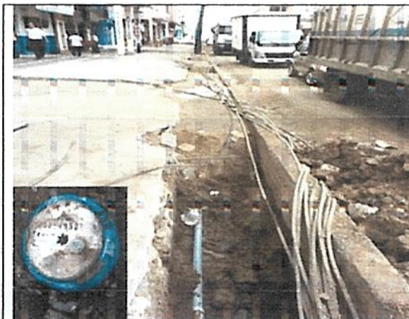
Gráfico 9.- Tubería Instalaciones de Politubo (mangueras), de manera antitécnica, que producen fugas de agua y Medidores en Mal estado
